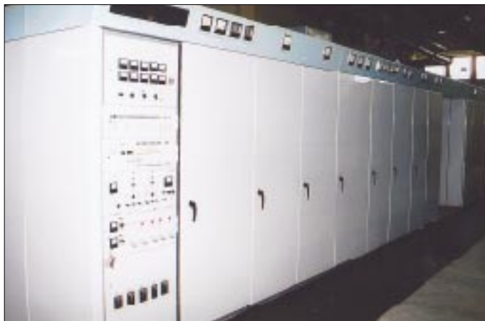
Der Sender PSW 1000 besteht aus zwei baugleichen 500-kW-Blöcken in Form solcher „Schränkände“
