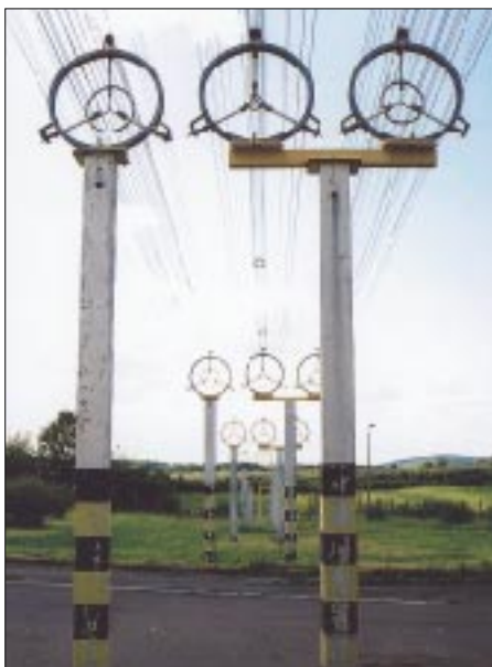
Speiseleitung und Transformationsleitung für die Quadratantenne
