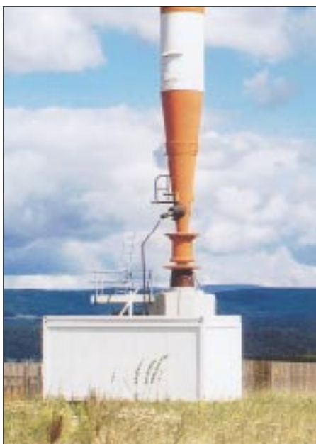
Container mit Antennenanpassung der direkt gespeisten Vertikalantenne
